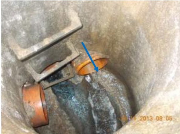
Pozo municipal con acometida trasera de nave industrial
