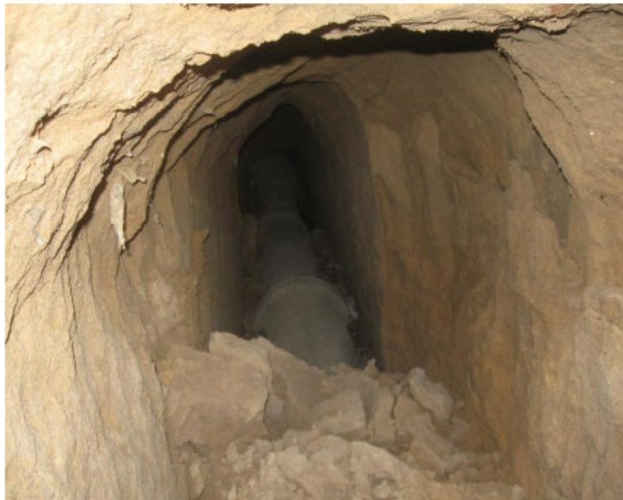
Detalle de colector y socavón oculto bajo firme
