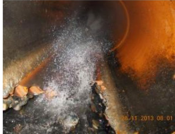
Detalle de colector dañado, visto desde pozo municipal
