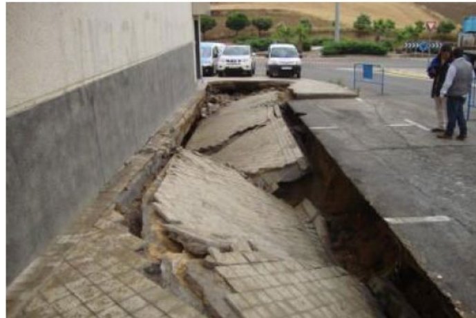
Colapso de 23 metros de acera sobre colectores dañados
