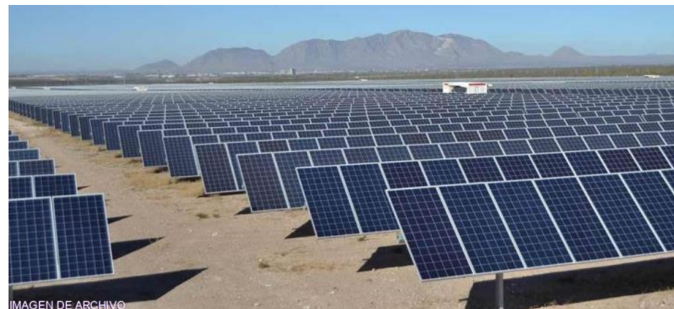
PROPIETARIO DE PLANTA FOTOVOLTAICA
